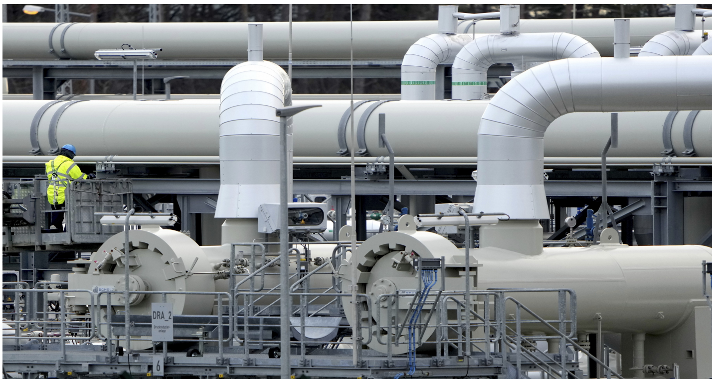
Des tuyaux dans les installations du gazoduc "Nord Stream 2" sont photographiés à Lubmin, dans le nord de l'Allemagne, le 15 février 2022. (AP Photo/Michael Sohn, Dossier)
