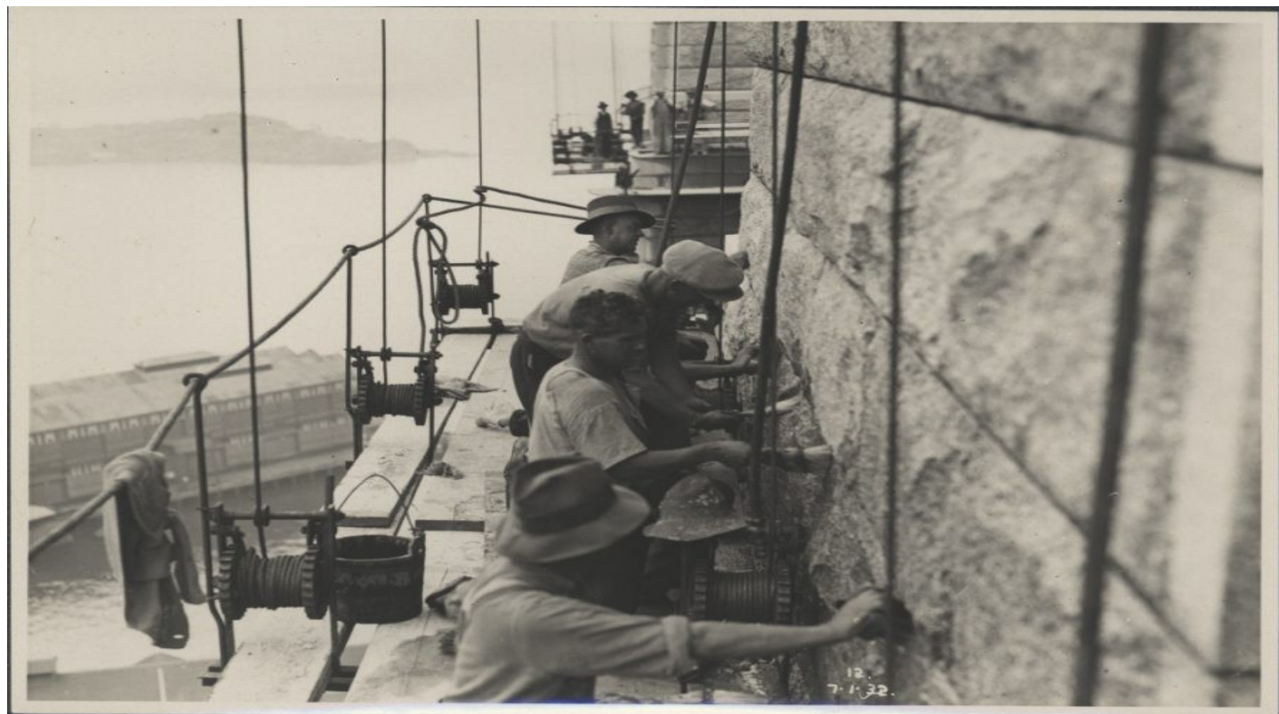
Ouvriers sur le pylône sud-ouest du Sydney Harbor Bridge, Sydney, Australie, 1932 (Musée Powerhouse)
