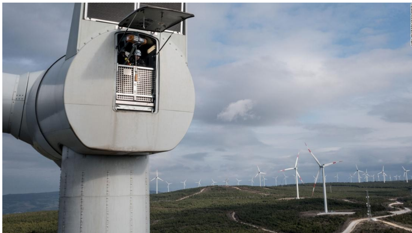
Des employés de la centrale éolienne de Canakkale du groupe Akfen Renewable Energy, en Turquie, procèdent à une vérification de routine de l'équipement au sommet d'une éolienne en décembre 2021 (CNN)
